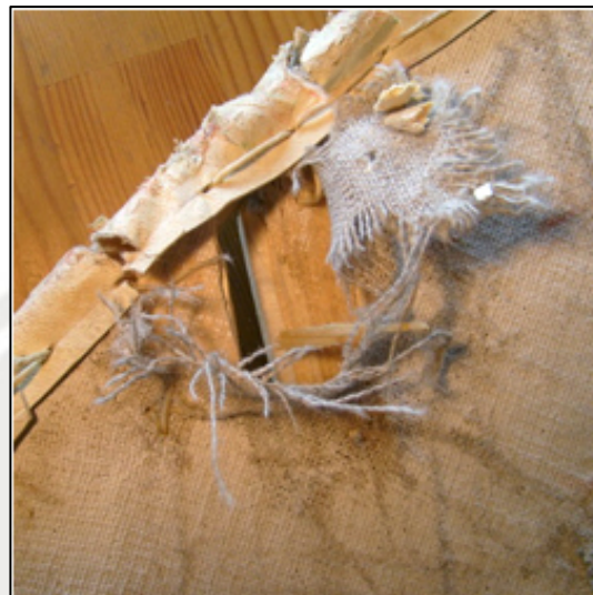
Schaden am Schildrand außen
